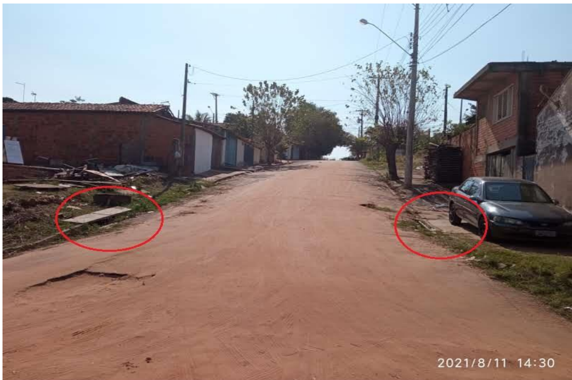
Figura 3: Outra vista da rua Domingos Rino Qt.01, com indicação - em destaque - das bocas de lobo duplas que deverão ser substituídas.
